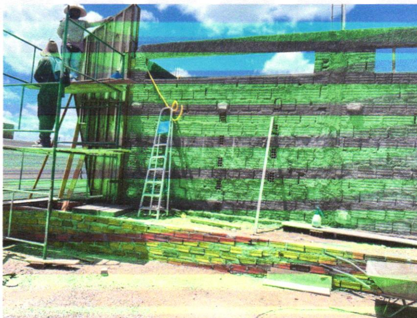
IMAGEM 10 - CHAPISCO APLICADO EM ALVENARIA (COM PRESENÇA DE VÃOS) E ESTRUTURAS DE CONCRETO DE FACHADA, COM COLHER DE PEDREIRO. ARGAMASSA TRAÇO 1:3 COM PREPARO EM BETONEIRA 400L. AF_06/2014
