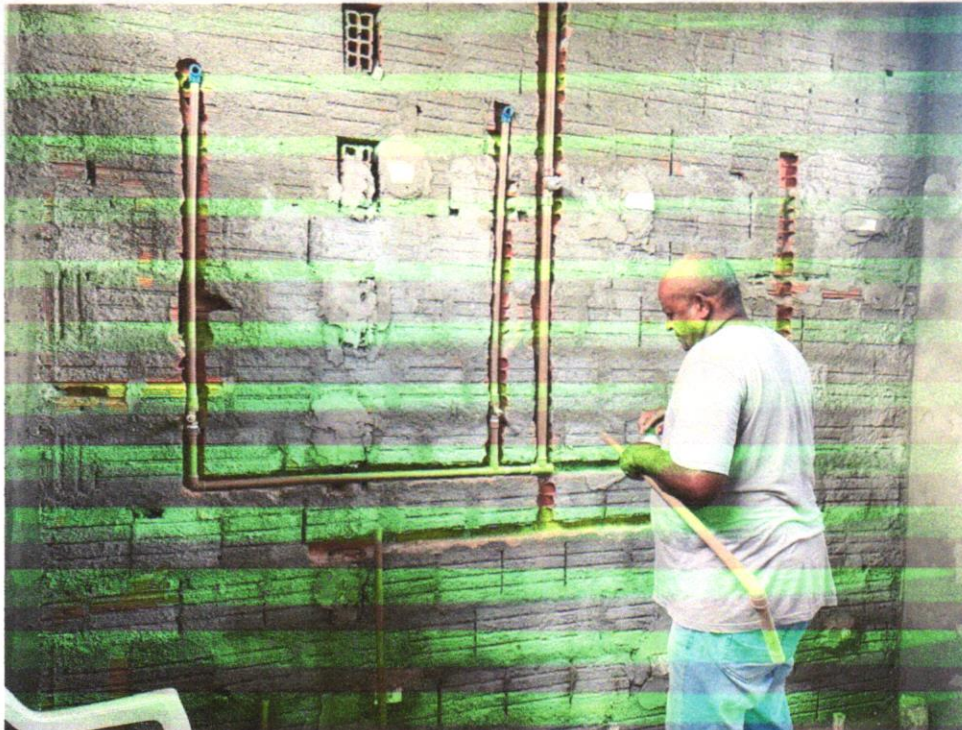
IMAGEM 14 – TUBULAÇÕES E CONEXÕES DE PVC
